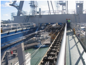
新西兰岸桥使用现场 New Zealand QCC's CBCS
