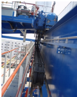
大连场桥的安装运行现场 Dalian, RTG/RMG's CBCS
