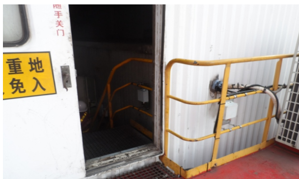
(机房入口 Machine Room Entrance)
