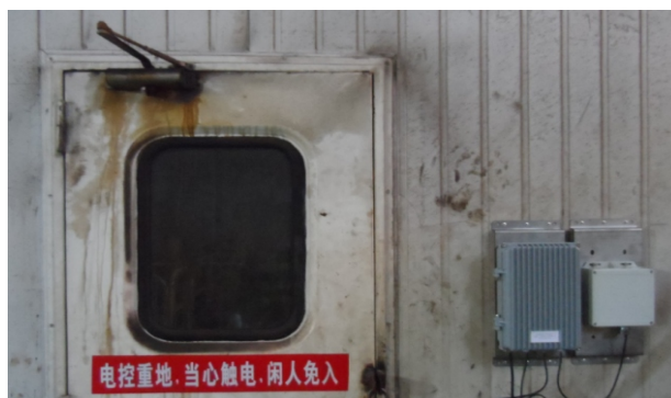
(电气房入口 Electric room Entrance)
